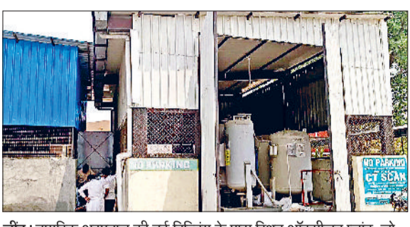
जीद। नागरिक अस्पताल की नई बिल्डिंग के पास स्थित ऑक्सीजन प्लांट, जो बूस्टर लगाने के बाद चलने लगेगा।
